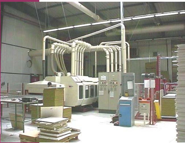
Vue d'ensemble de la ligne côté sortie.
