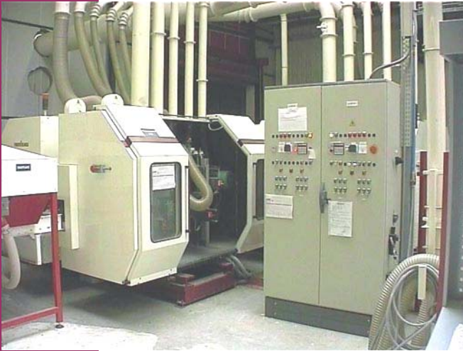
Calibreuse N°2 avec à côté le pupitre de contrôle de l'ensemble de la ligne.
