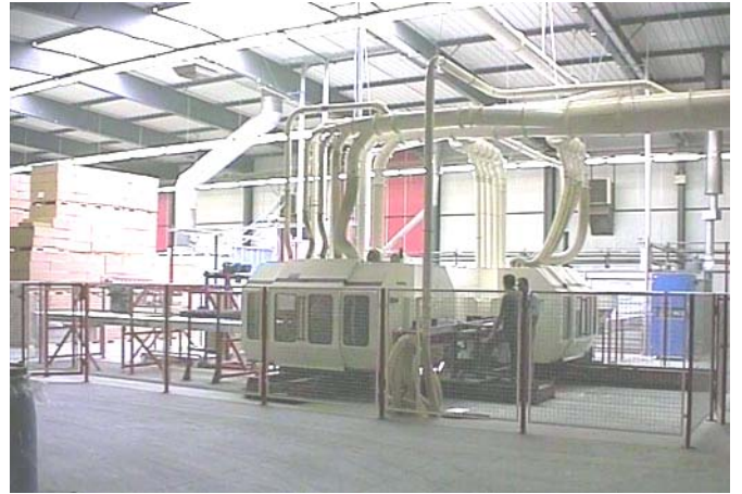
Vue d'ensemble de la ligne côté transfert entre les 2 calibreuses doubles.
