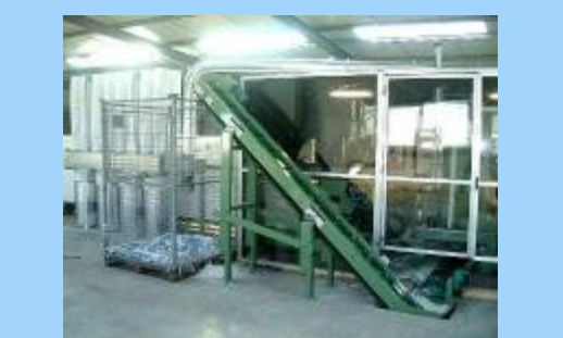
Système d'extraction et de relevage des chutes
